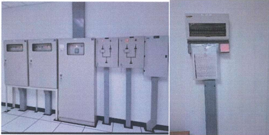
๕๓. ระบบไฟฟ้าภายในห้อง Data Center
