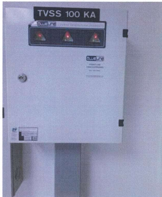
๕๔. ระบบป้องกันไฟฟ้ากระชาก (Surge Protection)
