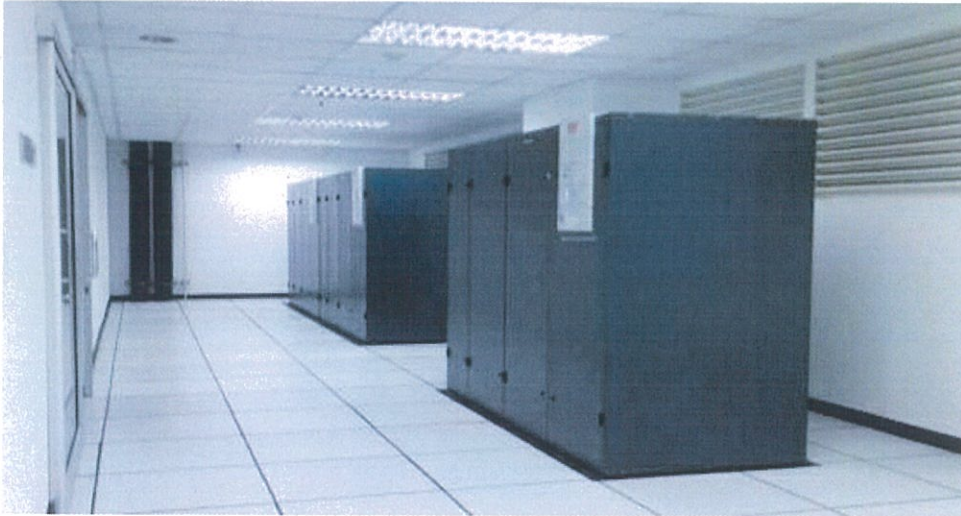
๕๖. ระบบปรับอากาศแบบควบคุมความชื้น
